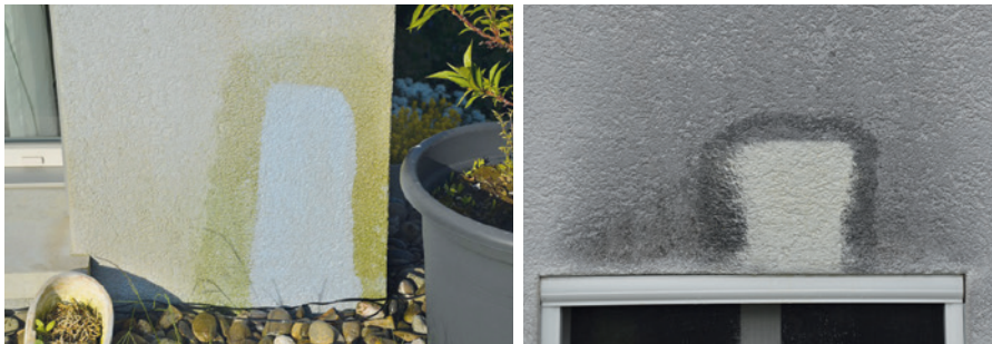
Eine Fassade mit Grünalgenbefall (links) und eine Fassade mit Schwarzschildbefall (rechts).
